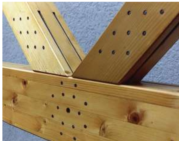
Fig.19: Tarugos metálicos insertados a través de chapas intermedias.
