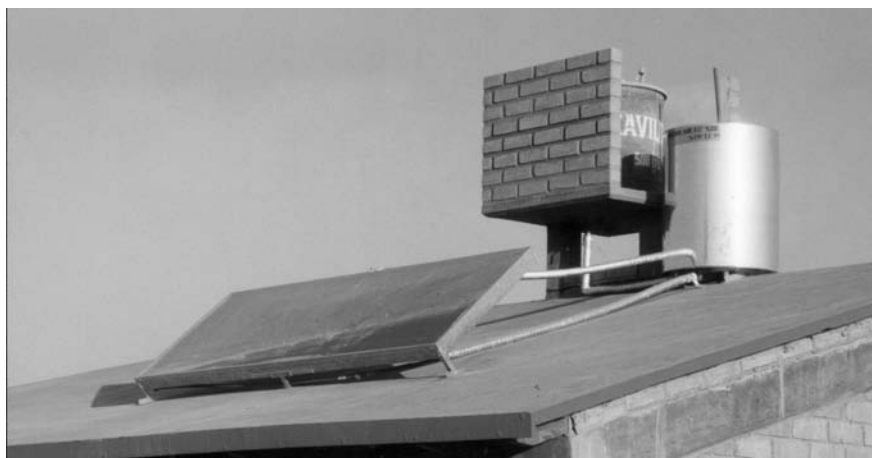
Sistema de calentamiento
