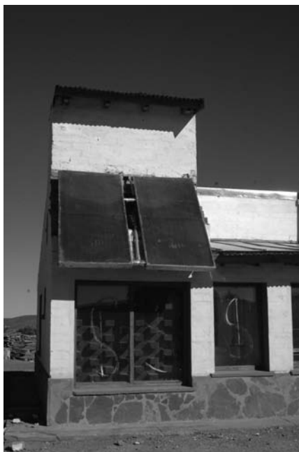
Sistema de calentamiento solar de agua
