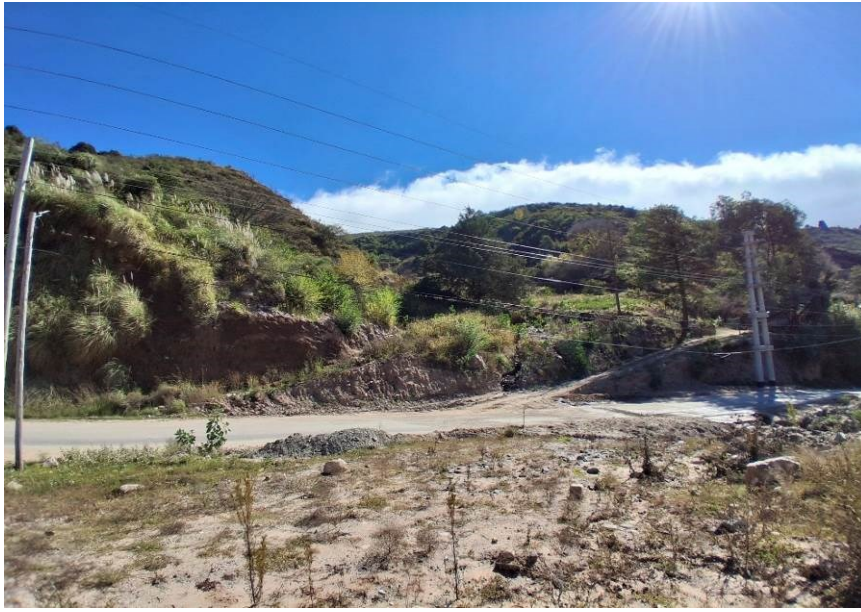
Foto IV.2: Situación a mayo de 2025 de la zona de la Foto IV.1. Se advierten procesos de revegetación en la cabecera del deslizamiento que contribuyen a su provisoria estabilización.
