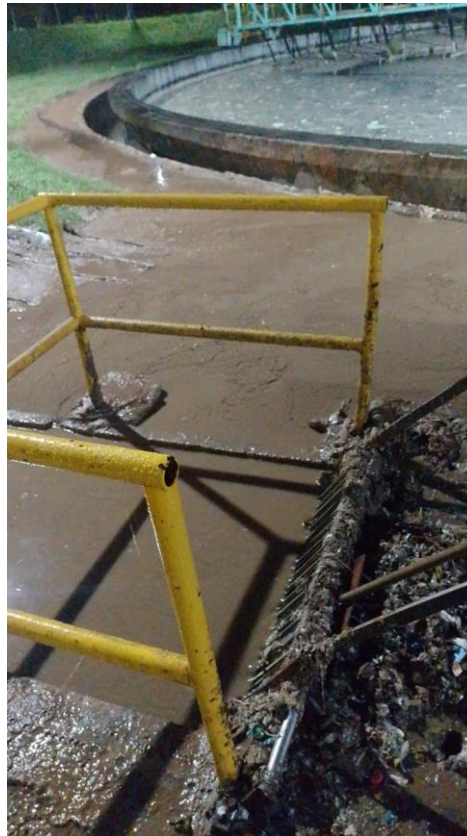
Figura 3.29: Reja fina en canal de entrada al clarificador obstruida y desborde de canal
