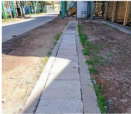
Figura 3.16: Canal para efluentes de planta
