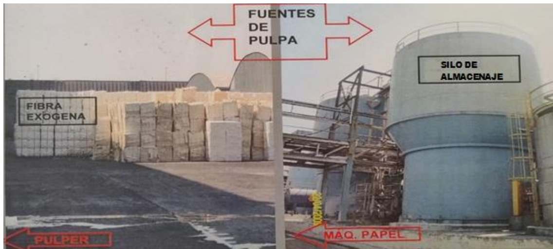
Figura 3.1: Recepción de materia prima exógena y silo de almacenamiento de fibra de bagazo (Recopilada de información interna de planta)
