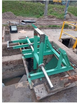
Figura 3.19: Montaje de reja mecánica
