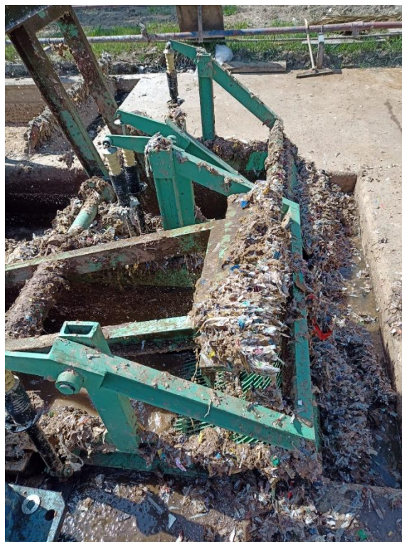
Figura 3.28: Reja mecánica colapsada por plásticos
