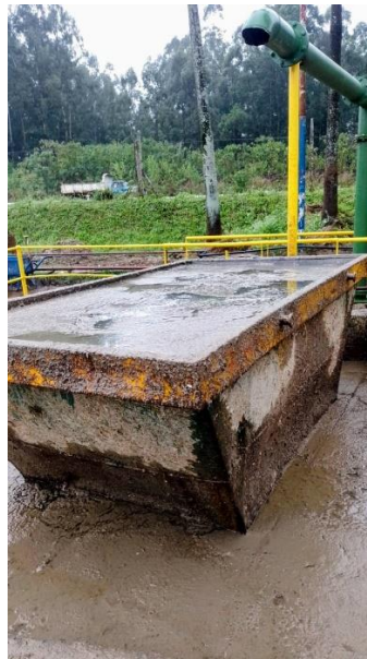
Figura 3.32: Material expulsado del desarenador que contiene fibras y líquidos.
